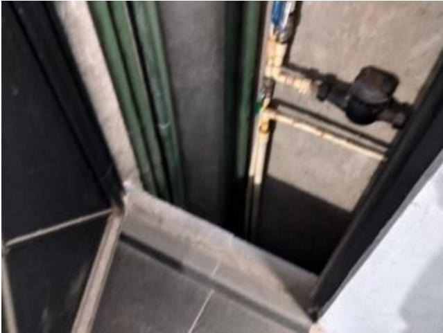
MEDIDOR DE AGUA
